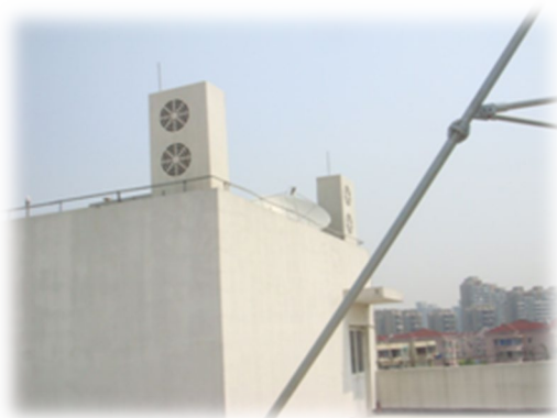
图3 仿空调室外机隐蔽罩
