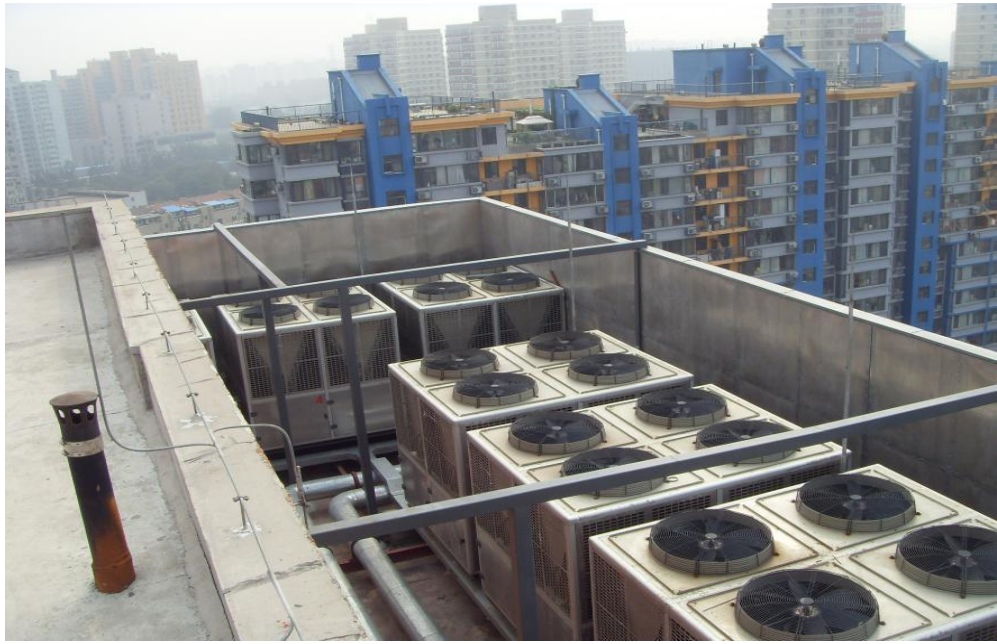
风冷热泵机组噪声控制工程案例（隔声屏障）
