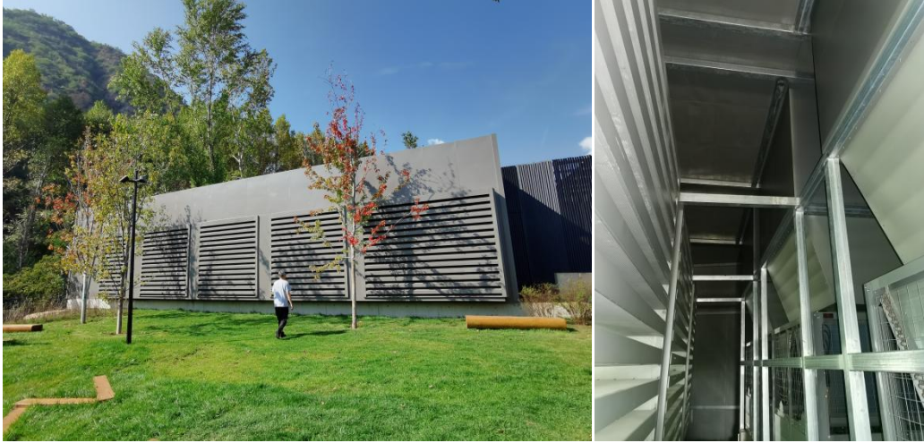
风冷热泵机组噪声控制工程案例（进排风消声与隔声罩）
