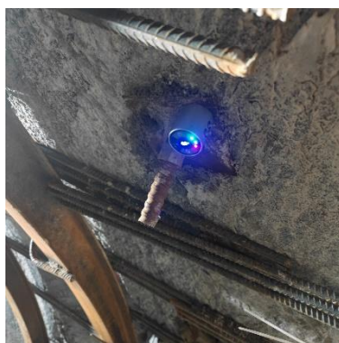
图 5 围岩表面传感器安装示例
