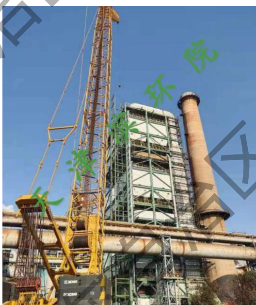
图3 宝钢 45 万标方热风炉脱硫除尘一体化项目装置图
