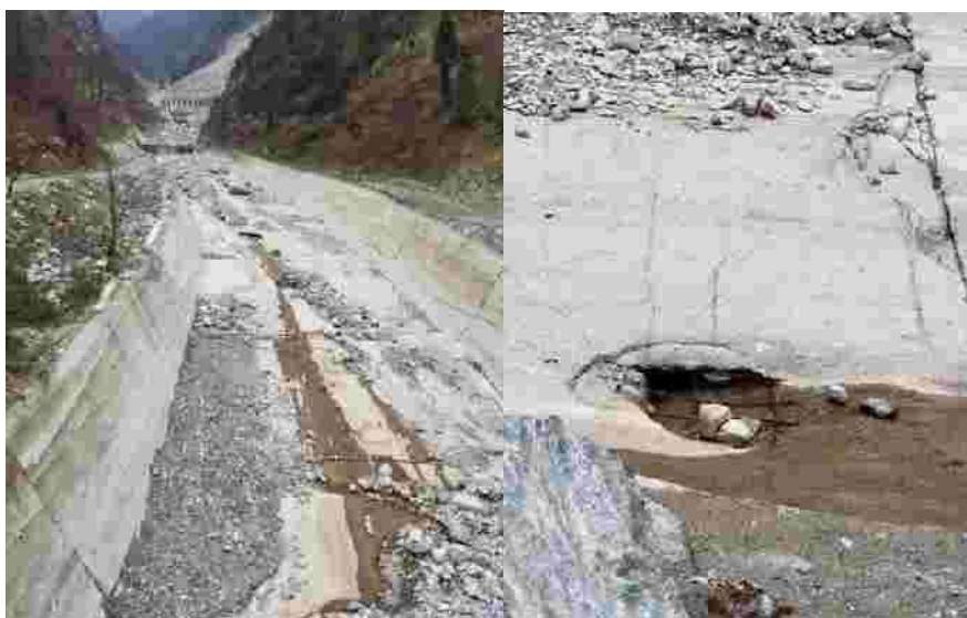
图 1.3 泥石流对排导槽的磨蚀
