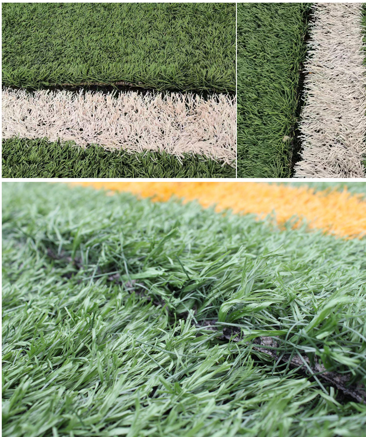
6.3.3 安装时填充颗粒用量不足或辅料流失未回填，草丝异常磨损掉草，使用寿命大大缩短。
