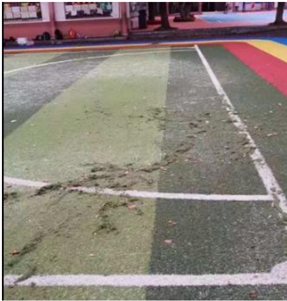
填充颗粒用量不足引起异常草丝脱落
