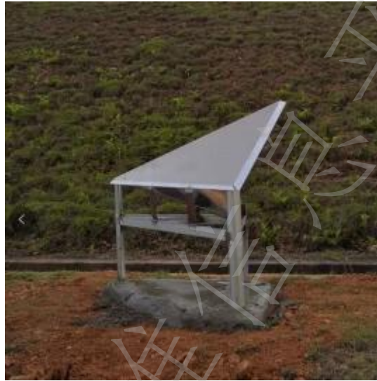
图 C.5 雷达角反射器实物图(安装于松子坑水库大坝)
