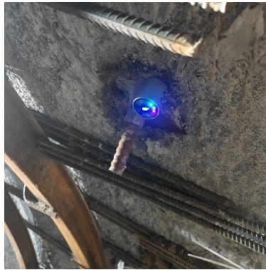
图6 围岩表面传感器安装示例
