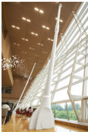
图 5 非膨胀防火体系全景
